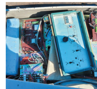
放送設備用機器
